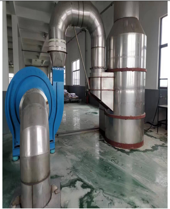
除尘系统废气密闭输送管道
