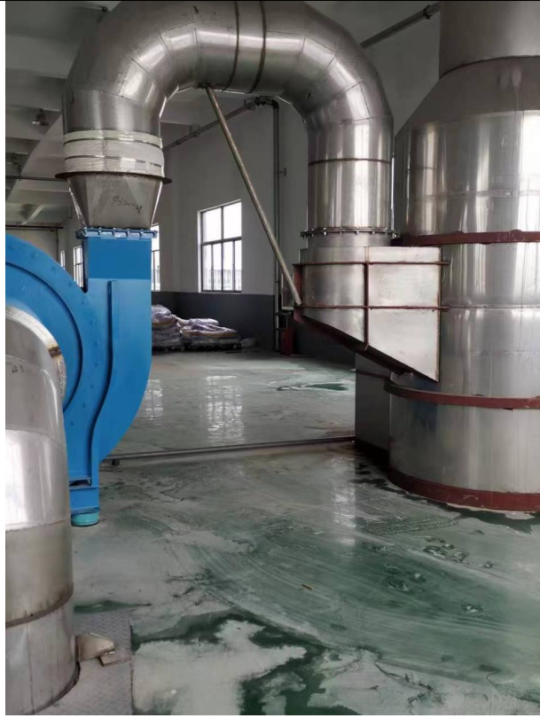
喷雾干燥废气收集处理设施
