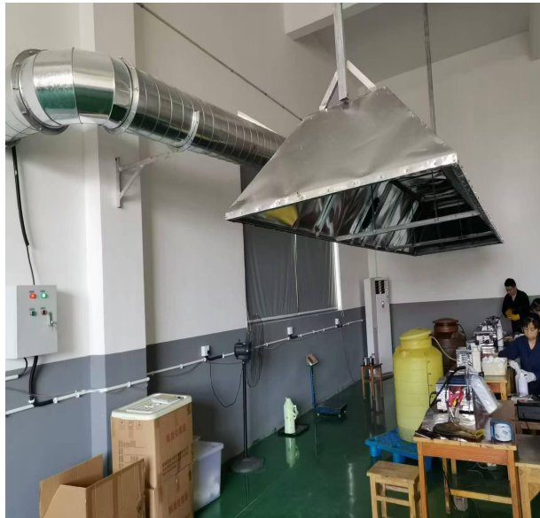
灌装有机废气收集系统
