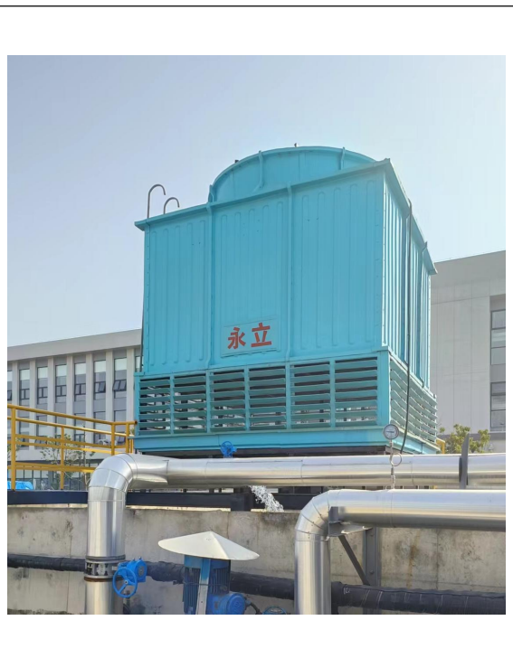
冷却水循环系统
