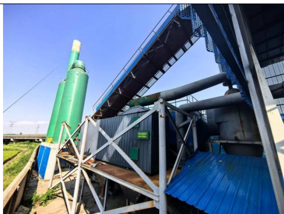
废气处理系统
