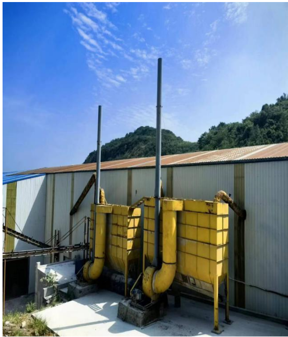
破碎、筛分生产线除尘装置
