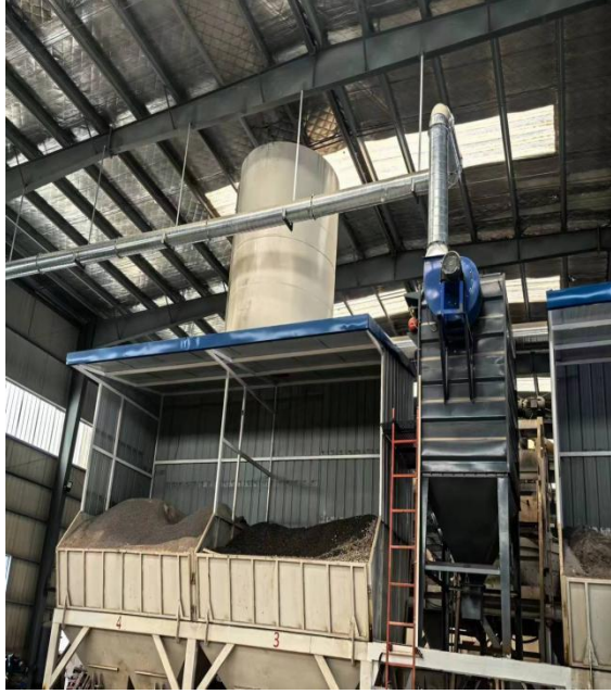
1#制砖生产线及除尘装置
